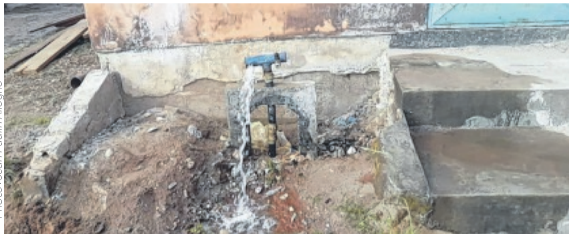
Une vue d'un compteur d'eau volé dans un domicile à Port-Gentil.
